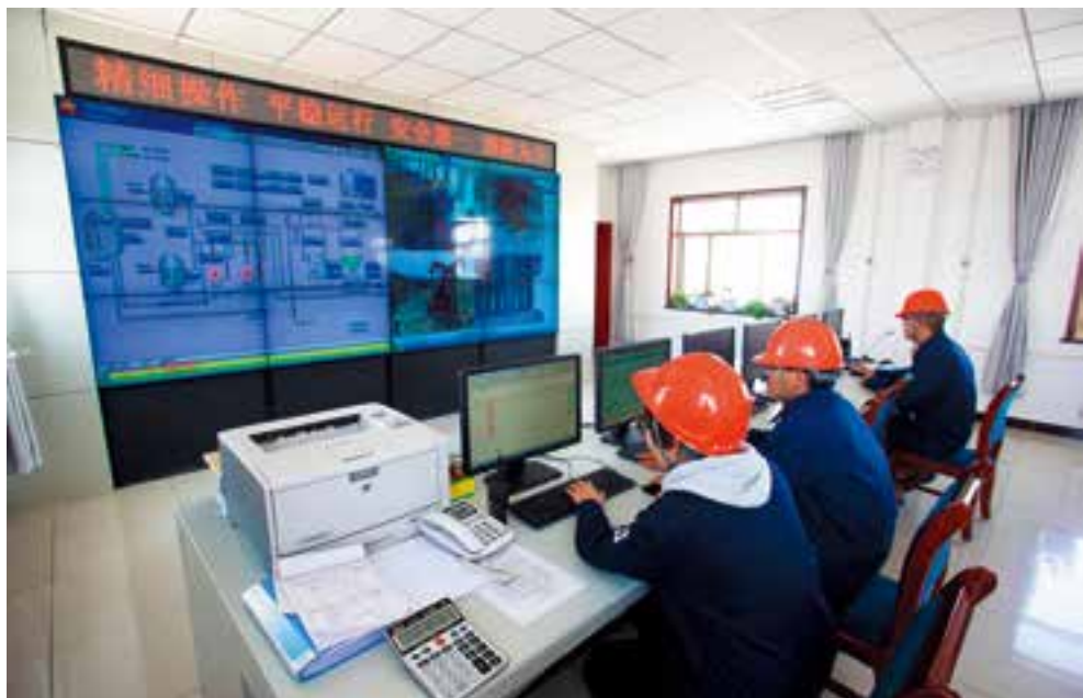
青海油田输气站中央控制室。国家将投资修建从青海到拉萨的天然气管道。
